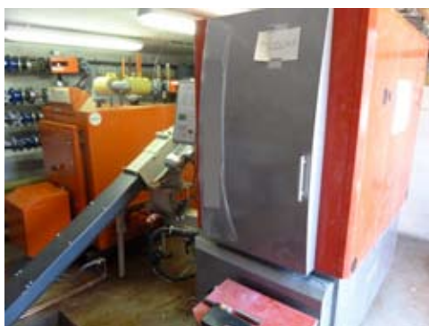
Chaudière bois énergie
